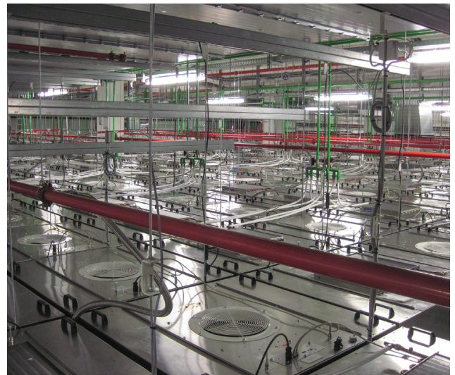
Plenum mit Sicht auf die Fan Filter Units
