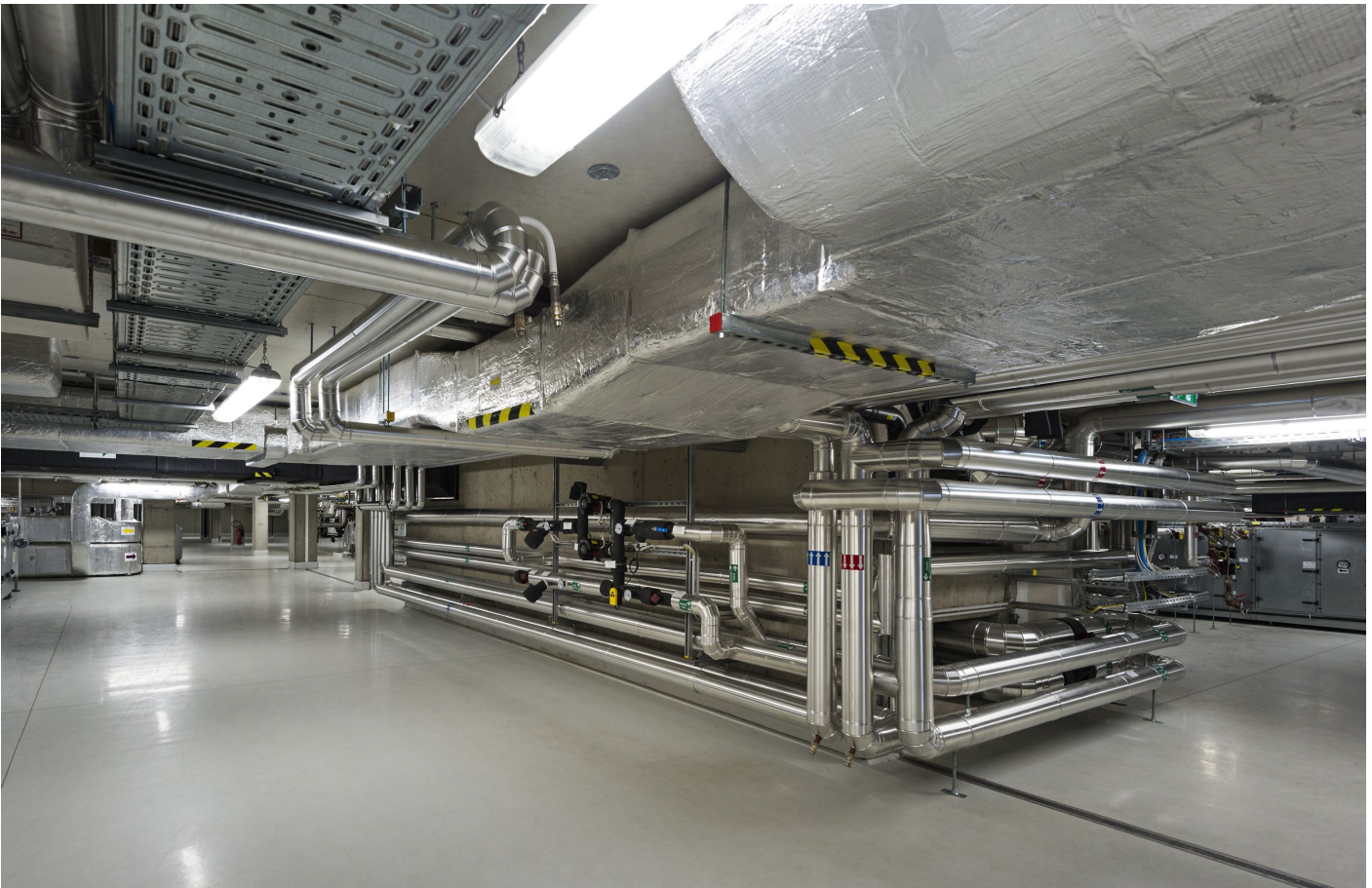
Technikzentrale in einem Pharma-Unternehmen / Technology center in a pharmaceutical company
