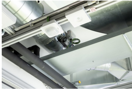
Druckregler (im Hintergrund, im Vordergrund die Sicherheitsbeleuchtung) gewährleisten jederzeit eine gerichtete Überströmung.
